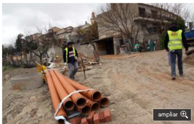
Varios operarios trabajando ayer en la canalización de las aguas pluviales. RUBÉN CERVERA
